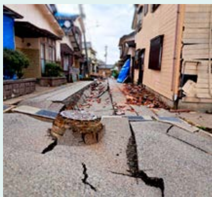
激しくひび割れて高低差ができた道路
