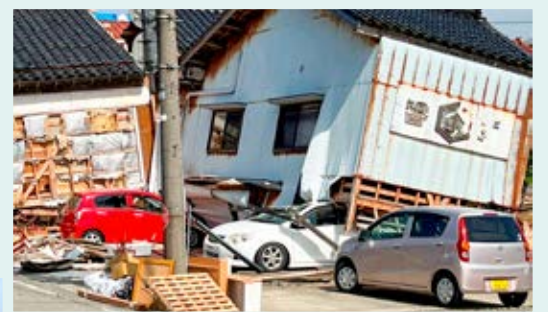
大きく傾き、崩壊した建物
